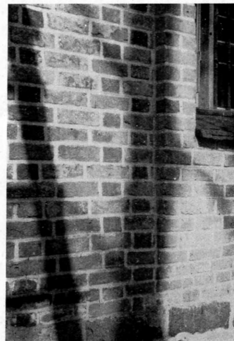
Fig. 9. Nedre delen av fogen omedelbart till vänster om sakristians fönster. Partiet upptill å bilden är delvis ommurat i samband med en förändring av fönstret.
