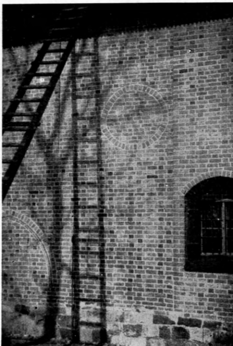
Fig. 8. Parti av sydfasaden vid övergången mellan sidoskeppet och sakristian. Uptill bakom stegen synes skarven i övre delen av murverket mellan sidoskepp och sakristia. Den genomgående fogen omedelbart till vänster om fönstret framträder mindre tydligt från detta håll. Jämför fig. 9!
