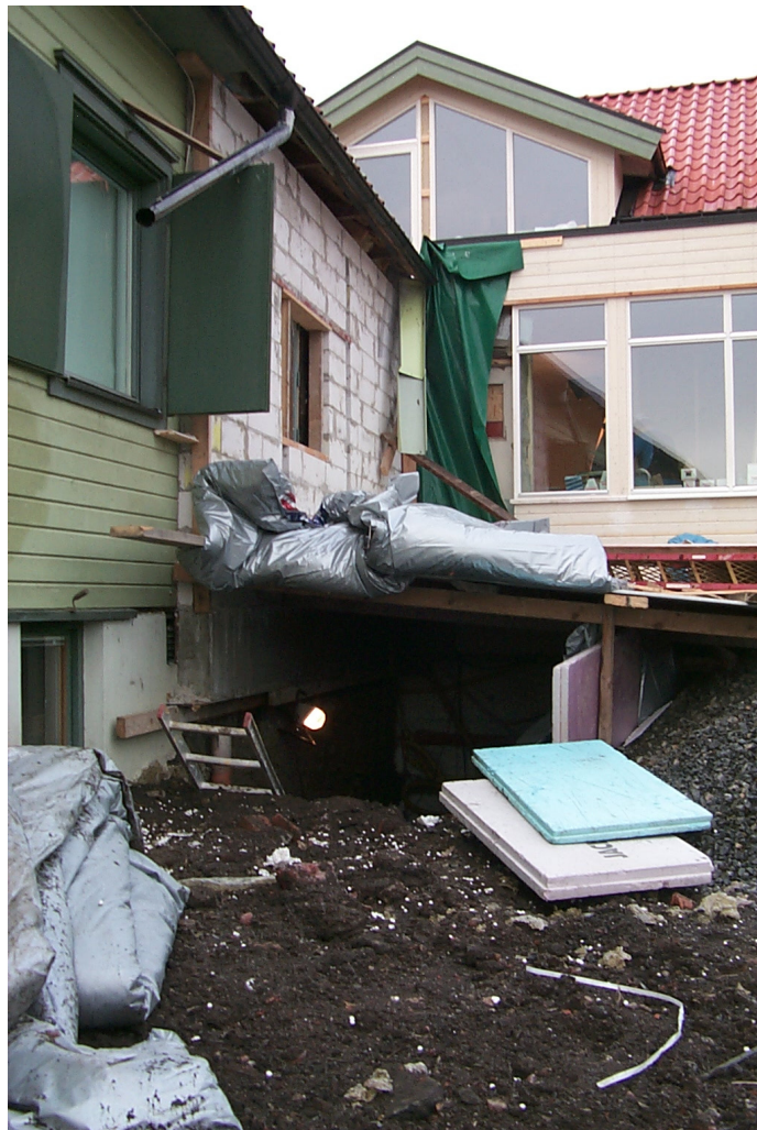
Till höger i bilden syns Gröna Ladan och rakt fram i bakgrunden syns det nybyggda huset i kvarteret Professorn 1. Framför huset ligger schaktet, som är övertäckt med ett tak.
