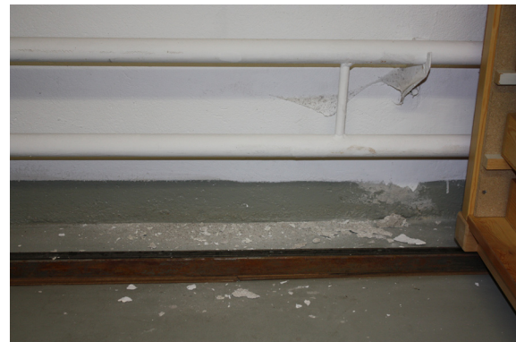
Fig. 18. Puts som fallit från tak- och väggskadan
