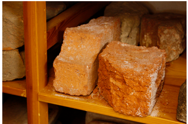
Fig. 30. Saltsprängningar i tegel
