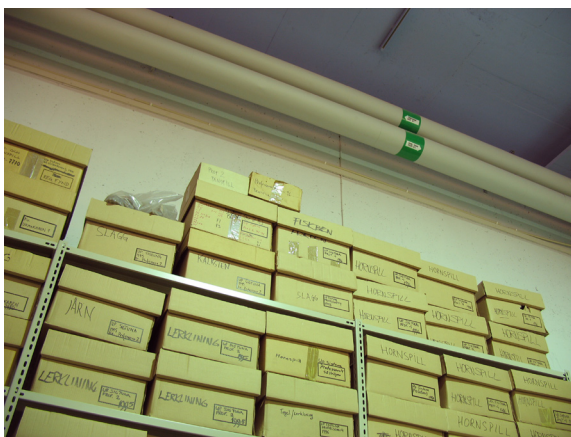
Fig. 5. Vattenledningar i taket
