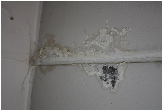
Fig. 16. Fuktskada i taket
