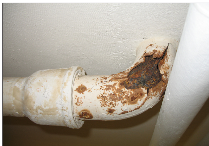
Fig. 24. Avloppsrör av järn som korroderar
