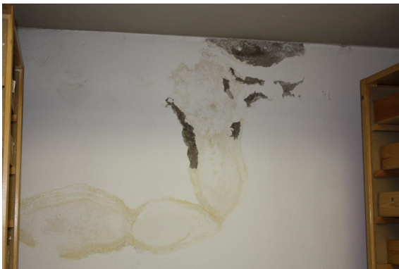
Fig. 17. Fuktskada i väggen relaterad till skadan i taket
