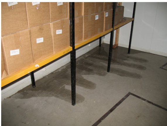
Fig. 4. I början på augusti 2010 inträffade en akut vattenläcka där vattnet rann ur sprickor i väggarna runt om i hela lokalen
