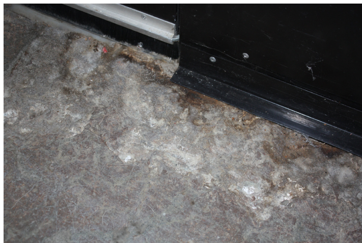
Fig. 43. Långvarig fuktproblematik i golvet vid glasdörrarna
