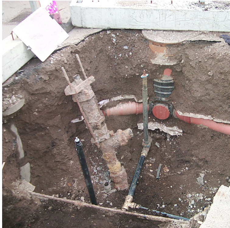
Gamla och nya avstängningskranar i schakt 5.
