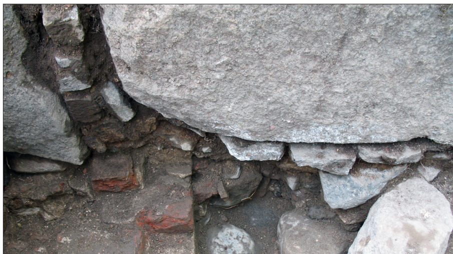
Figur 17 Närbild på skolstenar och utjämningskift i murverk C vid 2 meter.
