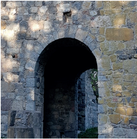
Figur 10. Ovanför den västra portalöppningen i centraltornet saknas en större sten, möjligen en kragsten som nämns av Brunius 1851.
